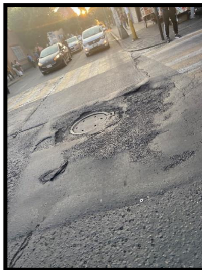
Imagen No. 7. Coladeras sumidas y mala pavimentación en Av. Benito Juárez, Toluca de Lerdo
